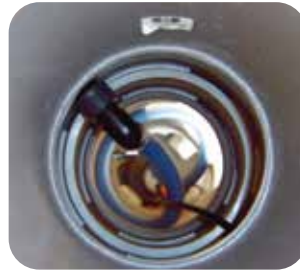
Position de la pompe au fond du regard
